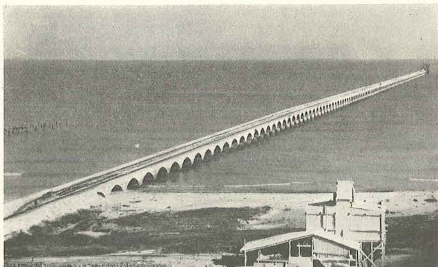
Fig. 5. En stor Del af Pieren færdig — den flytbare Arbejdsplads og Forskalling skimtes yderst til højre.
